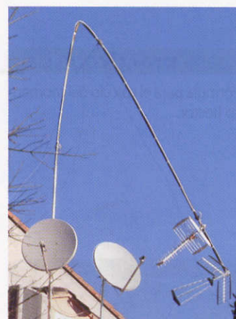
↑ Figura 4.51. Mástil doblado por mal arriestrado, con vientos mal distribuidos.
