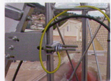
↑ Figura 4.54. Toma de tierra de la torreta.
